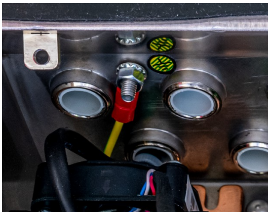
Fig. 36: Boulon de mise à la terre, boîtier pour environnements difficiles
