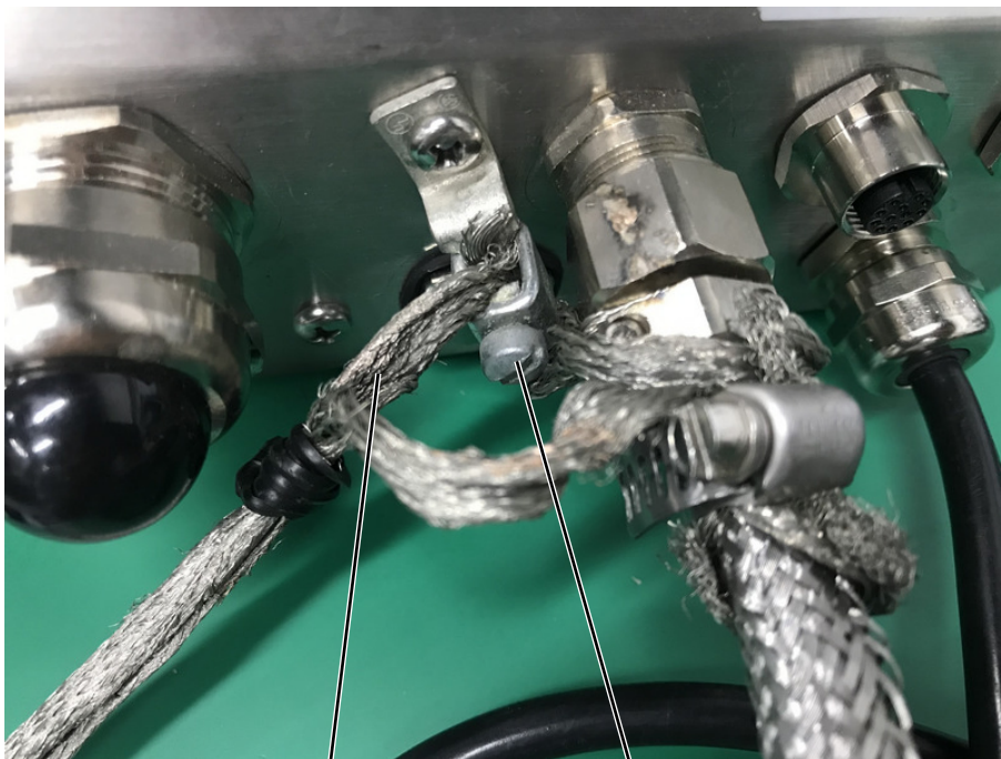
Fio de Drenagem Externo Dispositivo de Aterramento
